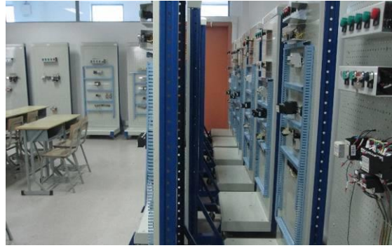
电气接线柜摆放整齐有序，面板上电器元件安装位置整齐规范
